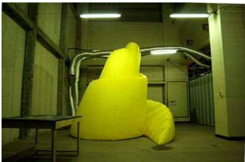
△モデルルーム時代の換気用ダクト部屋
