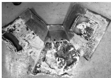
図13 腐食が進行した鉛板
