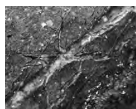
図10 ニス層の下にある クラック
